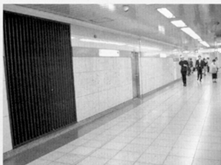
地下鉄東西線高田馬場駅の空調
